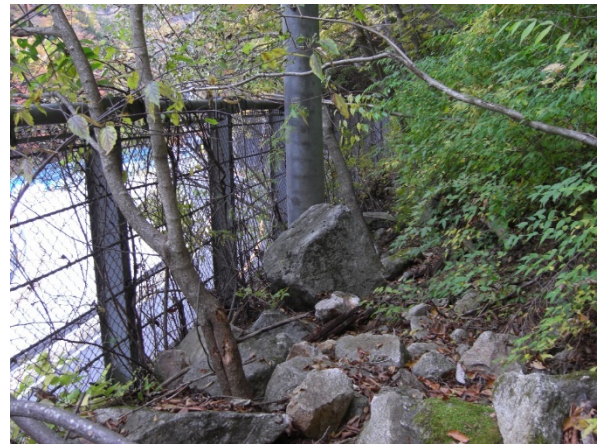
写真-3 現道防護柵表土、転石堆積
