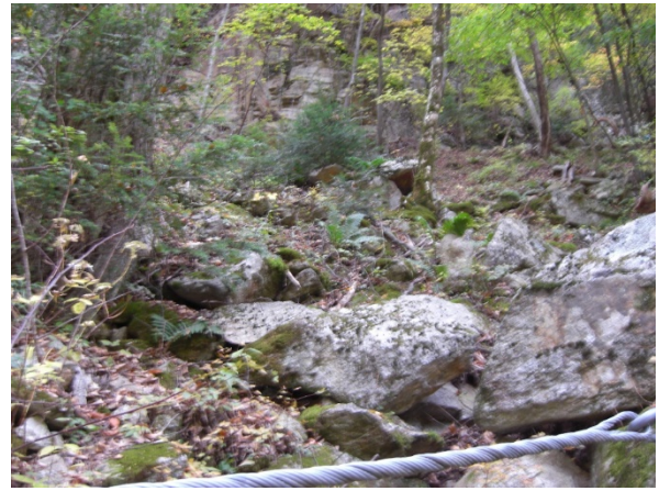
写真-2 到達側斜面の浮石
